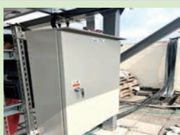
B棟頂樓架設太陽能板AC電源箱與逆變器
