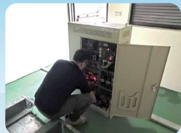
1150415 A棟電梯系統保養檢修
